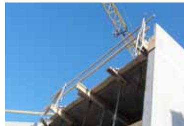
aux risques de chutes de hauteur et fatigants.
